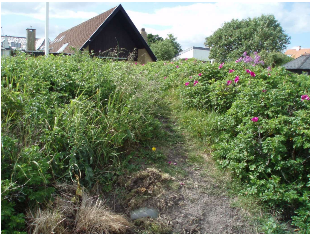
(3) Diget Strandvænget med truende erosion syd-vest siden for udløbet af rør LU 23g.
