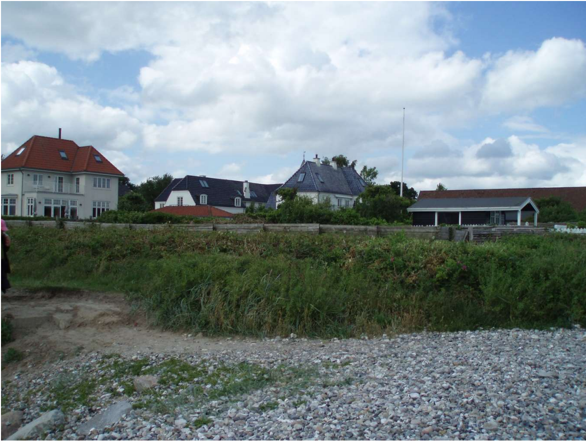
(1) "Hjørnet" af diget ved Strandparken i risiko for erosion.
